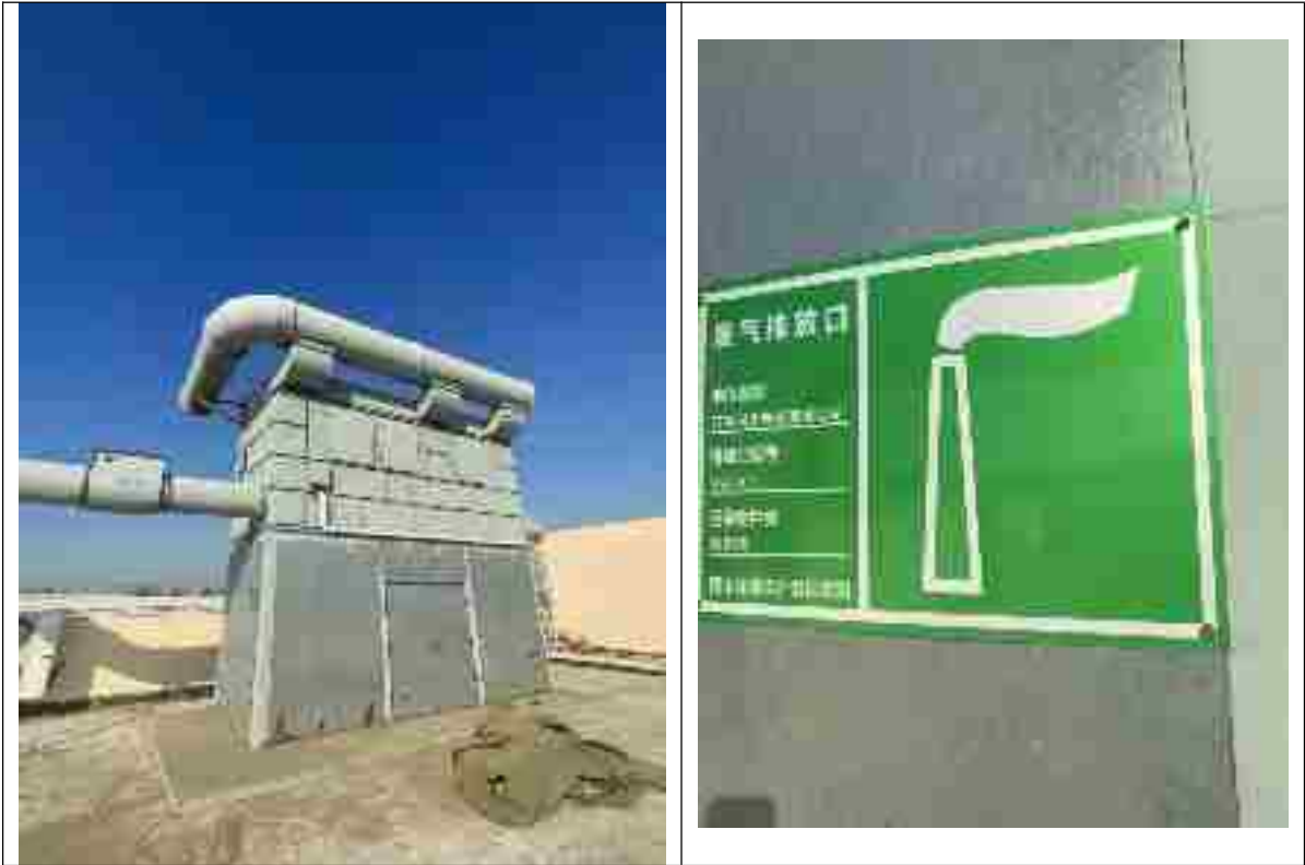
废气处理设施（袋式除尘器）+DA001 排气筒
