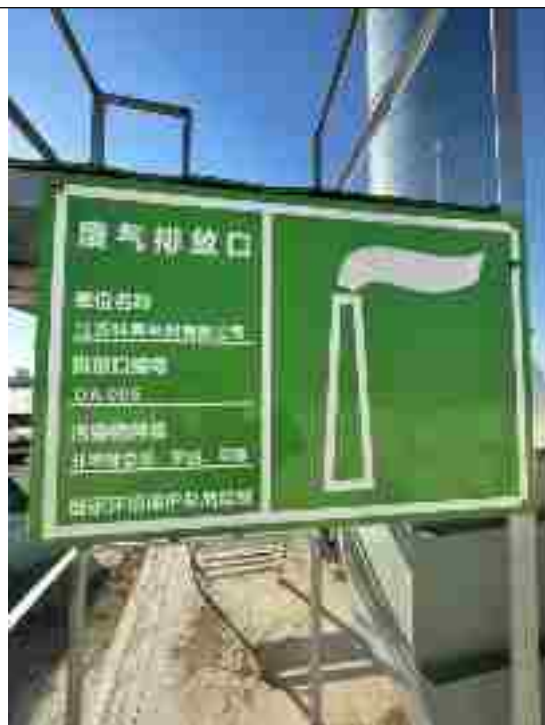
废气处理设施（二级活性炭）+DA005 排气筒
