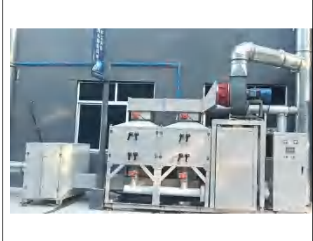
废气处理设施（活性炭吸附脱附催化燃烧）
