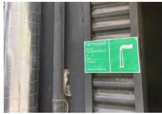
废气排口环保标识牌
