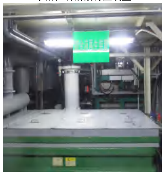
镀金液再生装置
