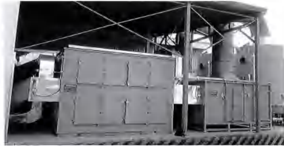
日资企业：曙光制动器（苏州）有限公司废气治理现场
