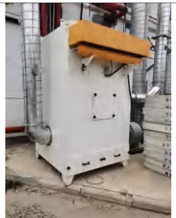
颗粒物废气处理设施
