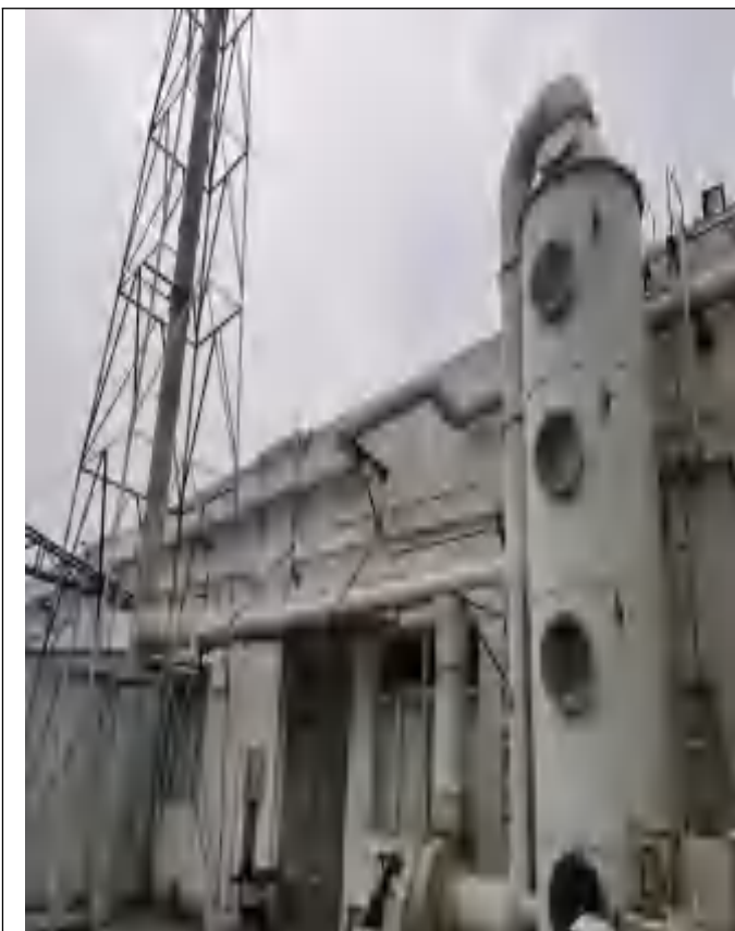
氰化氢废气处理设施
