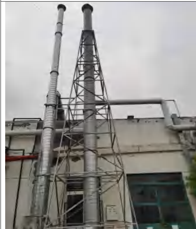
非甲烷总烃和颗粒物排气筒
