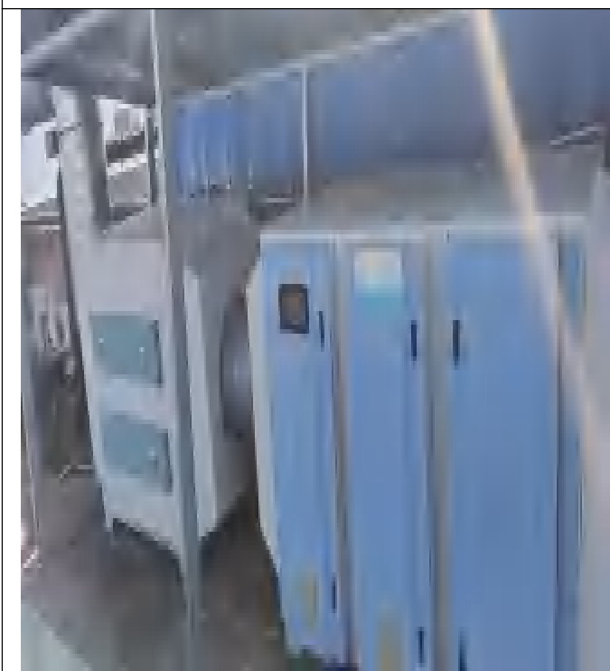
非甲烷总烃废气处理设施
