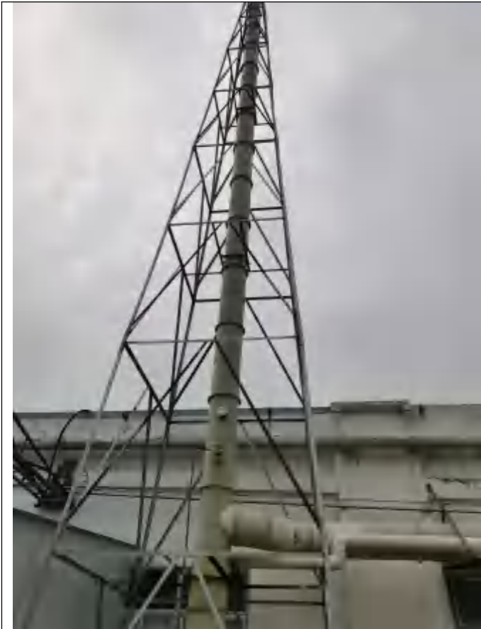
氰化氢废气排气筒
