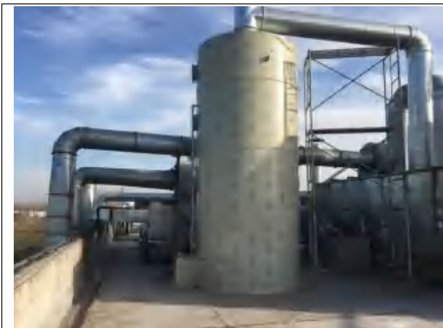
废气处理设施
