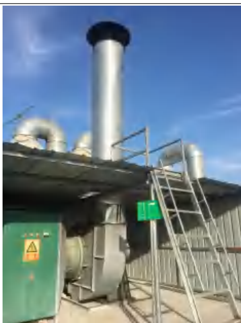
涂装废气排气筒
