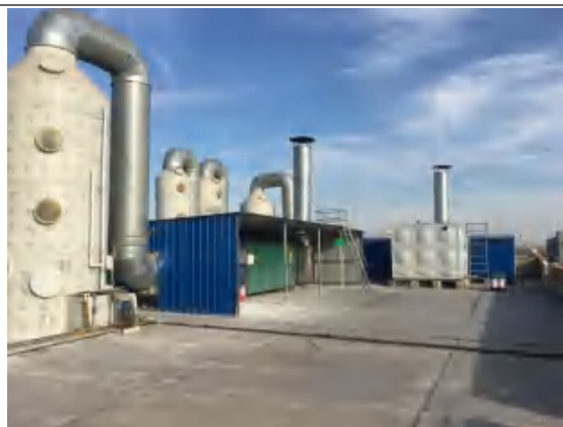
废气处理设施
