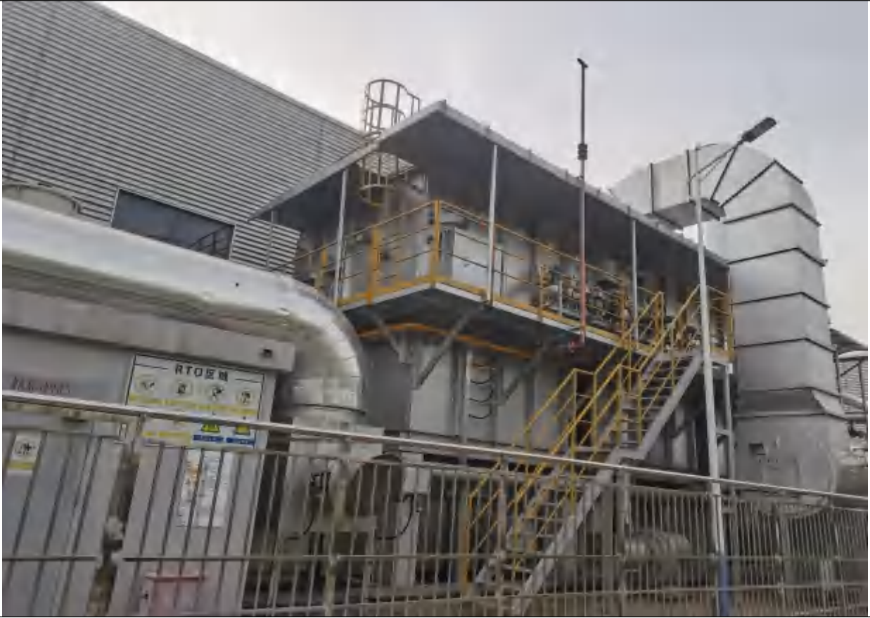
废气处理设施
