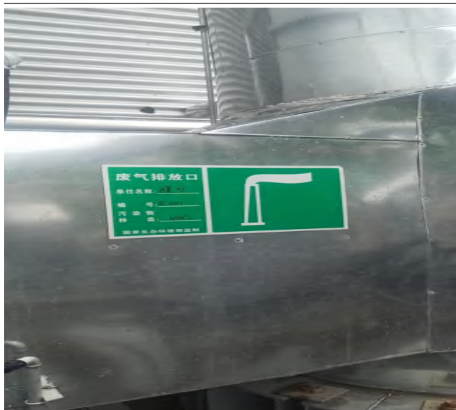
废气排放口标志牌
