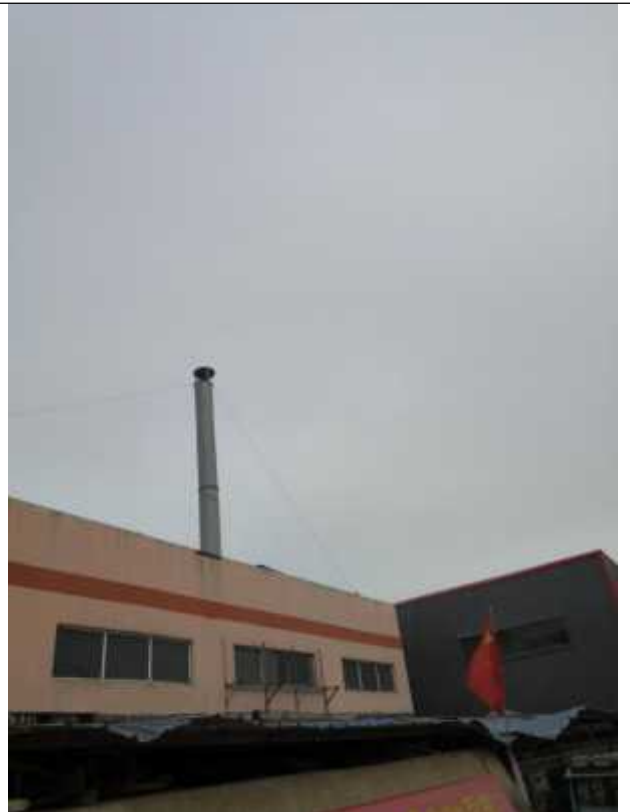
喷漆废气排气筒
