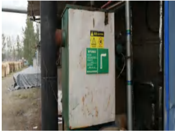
锅炉处理设施
