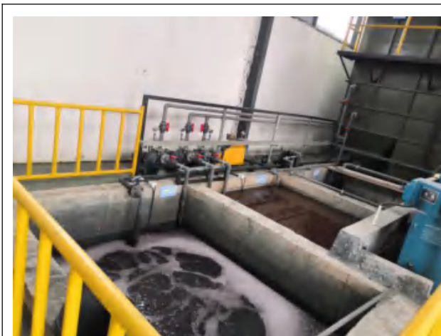
污水处理站设施
