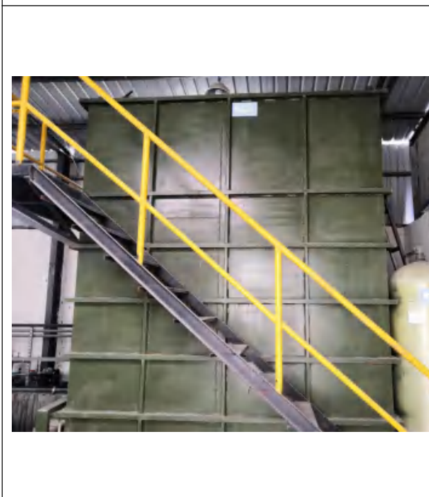
污水处理站设施
