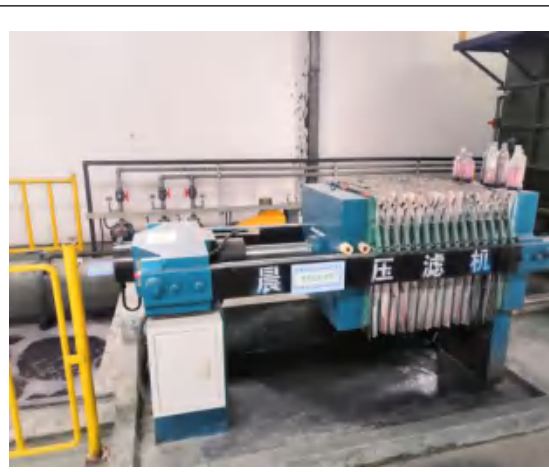
污水处理站设施
